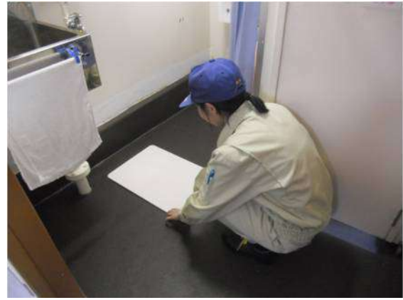
更新後の大島丸衛生設備例
