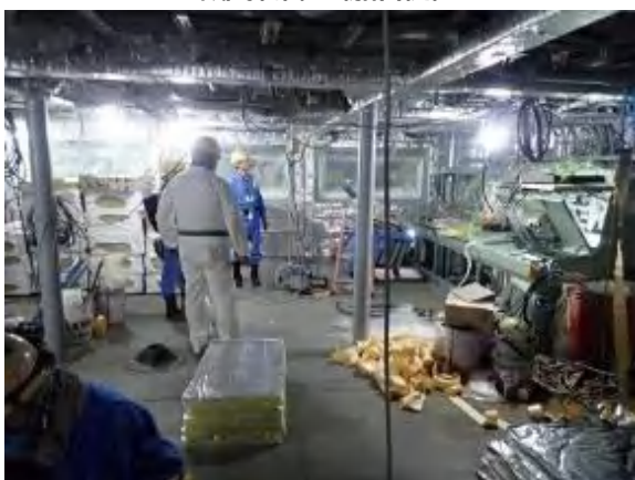
機関制御室(船尾側)
