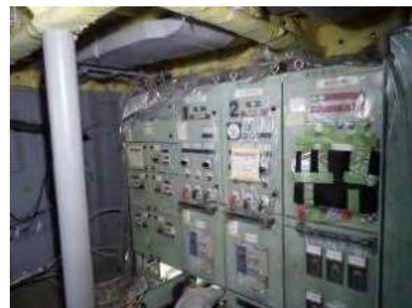
訓練用制御盤
