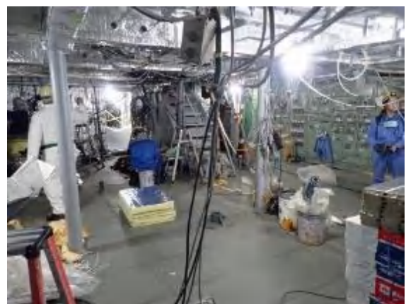
機関制御室(船首側)
