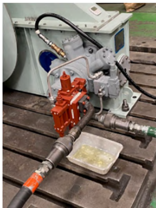
写真2 係船機油圧部分
