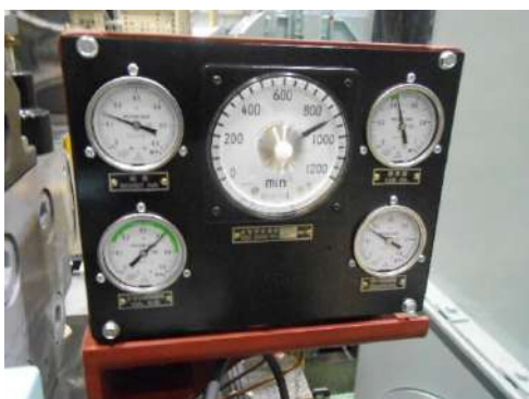
写真 5 保護装置試験時に確認される計測器
