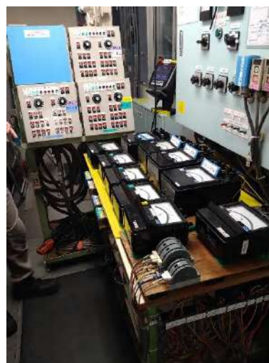
写真3 制御室内の負荷変動設備及び電圧・周波数確認設備
