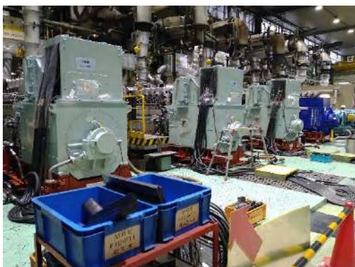
写真1 新大島丸の発電機3台
